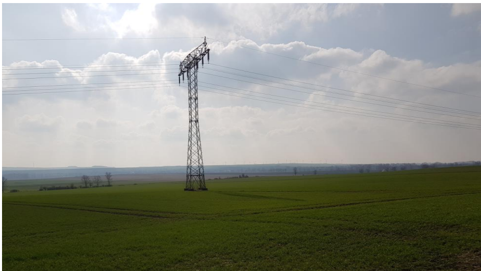
Abbildung 9: Freileitung im Vorhabengebiet
